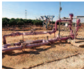
Odsolovací stanice brakické vody
