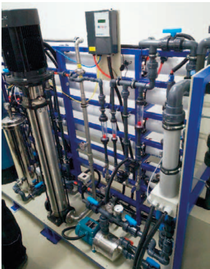
Pilotní jednotka RO s vysokou výtěžností
