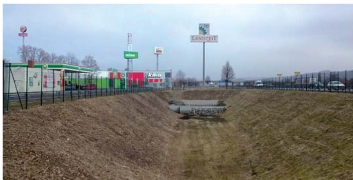
Celkový pohled na objekt HDV tvořený odlučovačem a zasakovacím objektem
