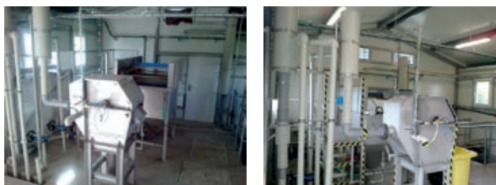
Detail rotačního síta, vzadu flotační jednotka
