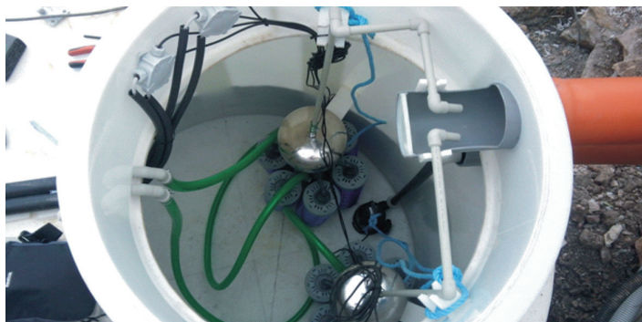
Obr. 3 – Pohled do nádrže mikrofiltrace
