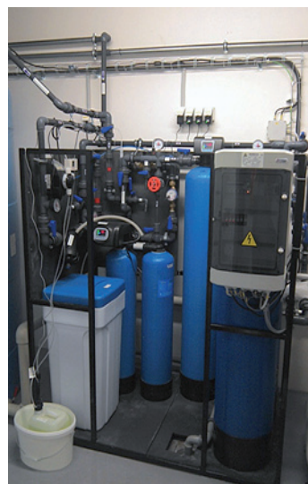
Celkový pohled na systém úpravy vod
