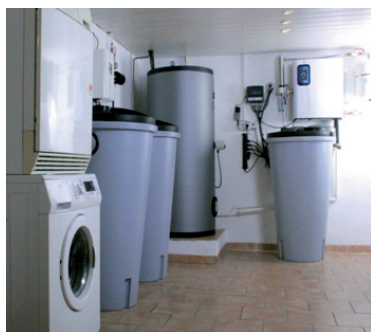
Obr. 2 – Technická místnost – umístění nádrží
