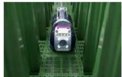
Obrázek č. 4: Pojízdná revizní kamera ve vsakovací galerii při kontrole
