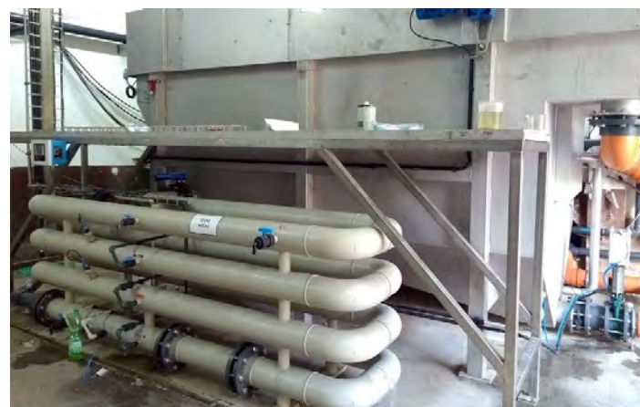
Technologie čištění odpadních vod založena na flotačních procesech
