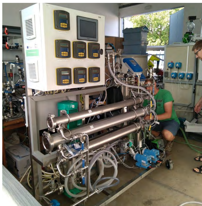
Pilotní ultrafiltrační jednotka
