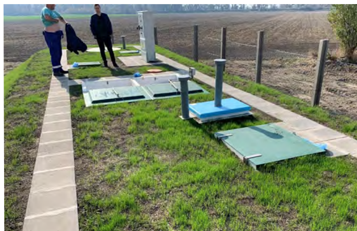
Obspané nádrže ČOV, finální podoba technologie
