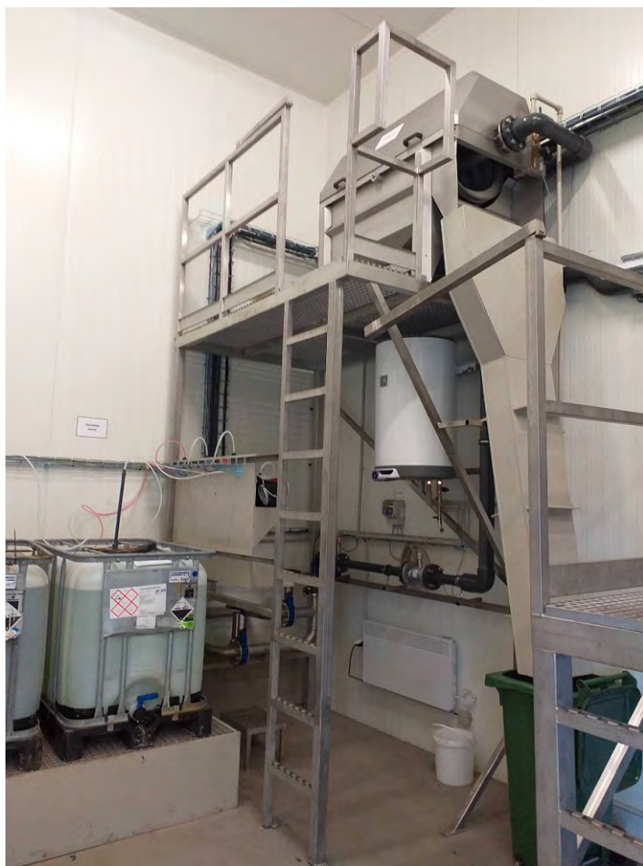
Mechanické předčištění OV
