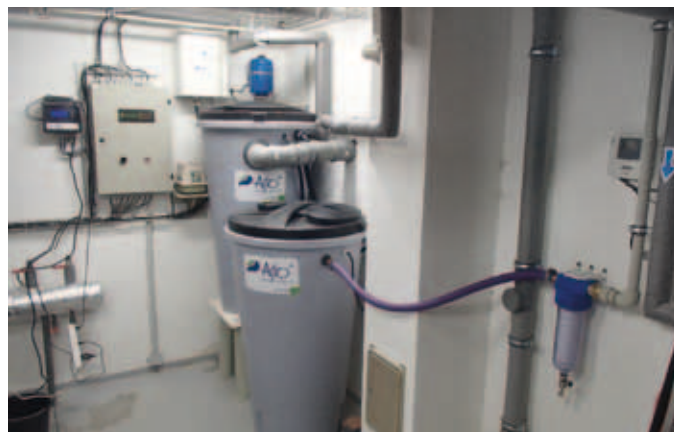
Obr.: Čistírna šedých vod AS-GW/AQUALOOP umístěna v suterénu domu
