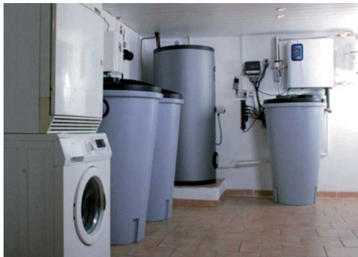
Obr. 1: Celá technologie na úpravu šedé vody včetně zásobníku teplé užitkové vody
