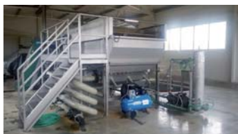
Obr. 1: Pohled na instalovanou flotační jednotku
