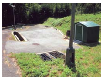
Původní čistírna odpadních vod Vojslavice
