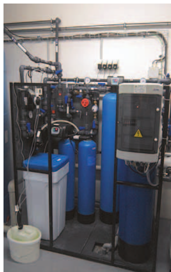
Celkový pohled na systém úpravy vod
