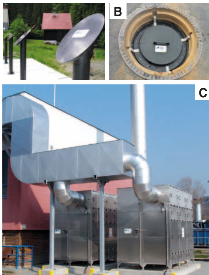
Obr. 1 - a) sorpční filtry v komínku, b) sorpční filtry na kanalizační šachty, c) jednotka fotokatalytické oxidace
