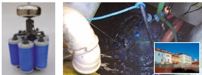
Obr. 1: systém na čištění šedých vod v Hotelu Galant**** v Mikulově
