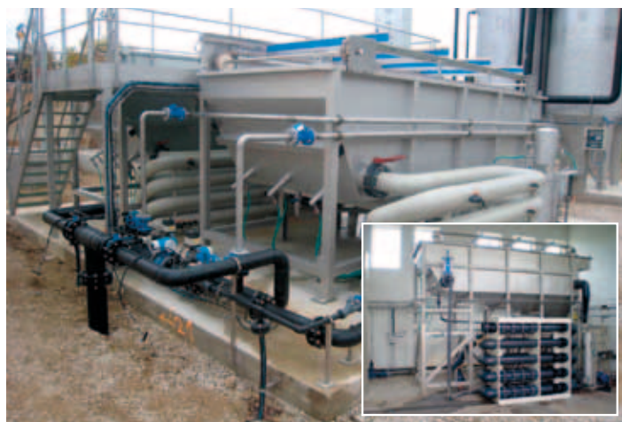
Foto: technologie čištění odpadních vod založená na flotačních procesech
