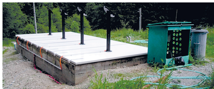
Obrázek 6. Příklad sorpčního filtru na odvětrávacím potrubí na čistírně odpadních vod
