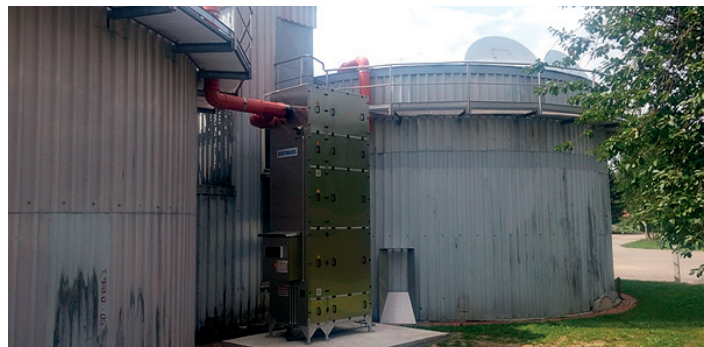
Obr. 2: Jednotka AS-PCO NOX1450 na ČOV Ivančice
