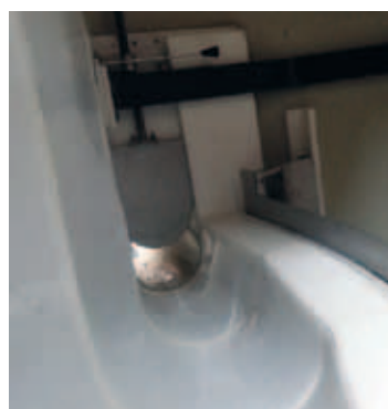
Pohled na odtok z odlehčovací komory do škrtkící tratě s osazeným nerezovým nastavitelným hradítkem pro redukci nátoků a s nerezovou nastavitelnou přelivnou hranou na hraně žlabu.
