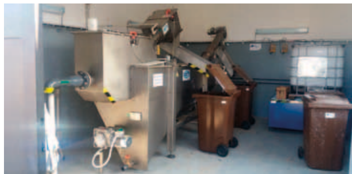
Objekt integrovaného mechanického předčištění
