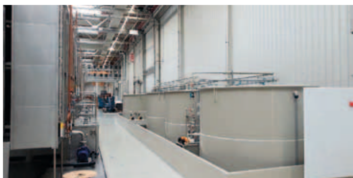
Dávkovací čerpadla hydroxidu sodného
