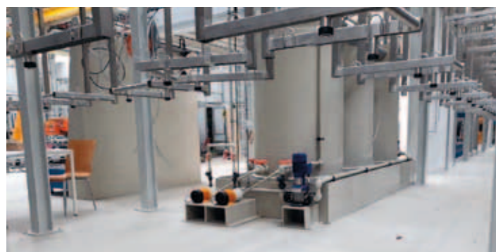
Akumulační nádrže o objemu 27 m 3
