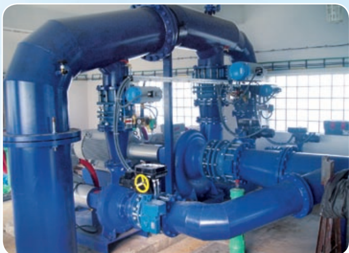
Čerpadla v turbínovém provozu
